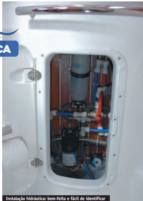
Instalação hidráulica: bem-feita e fácil de identificar
